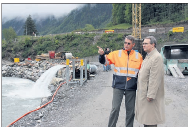
Informiert den Gemeindepräsidenten umfassend: Bauunternehmer Fritz Trümpi (links) bei der Baustellenbesichtigung im Gespräch mit Dr. Thomas Hefti.
