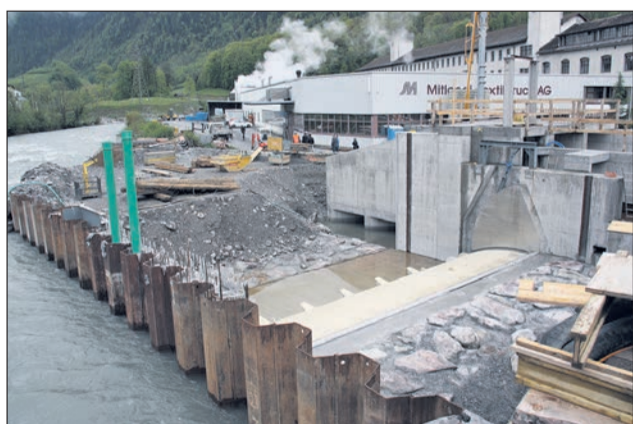
Für Stromproduktion und zum Schutz: Das Wehr des Kraftwerks Seidendruckerei ist so ausgelegt, dass es ein 100-jähriges Hochwasser sicher ableiten kann.
