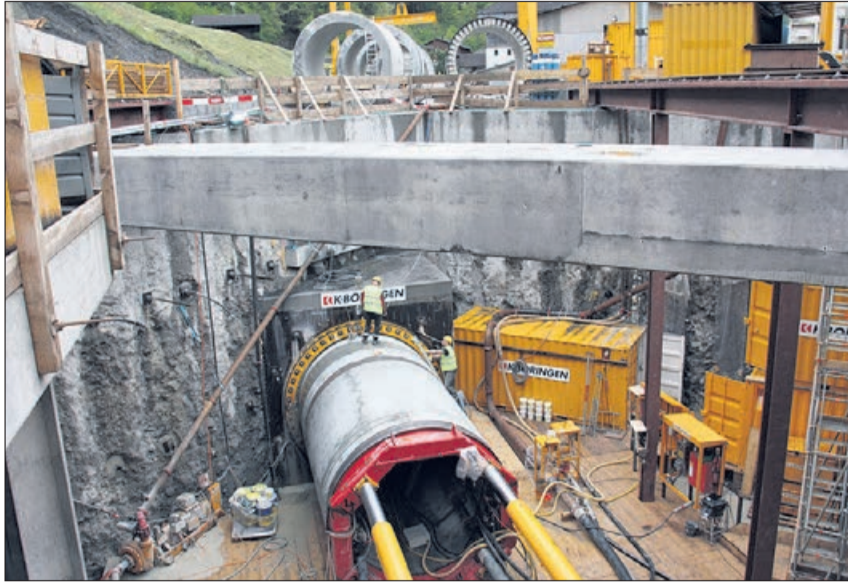
Gewaltige Baugrube in Mitlödi: Vom Startschacht in Ennetlinth wird der Druckstollen für das Doppelpower-Kraftwerk bis hinauf nach Schwanden gebohrt.
